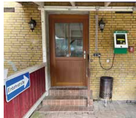
Der neue Defibrillator ist gut zugänglich und hängt an der Außenwand des linken Stallgebäudes in Grumby 2.
