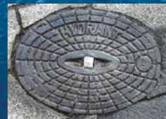
Hydrant (Unterflurhydrant) auf Straßen oder Gehwegen. Nicht zustellen oder darüber parken! Auf die Lage der Hydranten verweist das rot umrandete weiße Schild. (siehe oben, erstes Zeichen von links)
