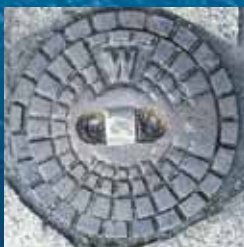
Schieberarmatur auf Straßen oder Gehwegen zur Sperrung von Rohrleitungen. Auf ihre Lage verweist das blaue Schild. (siehe oben, zweites Zeichen von links, steht im Deckel anstatt des „W“ ein „A“, dann handelt es sich um einen Abwasserschieber, siehe grünes Zeichen)
