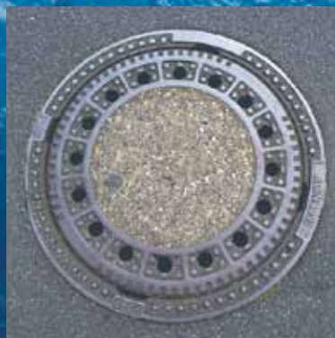
Einsteigschacht. Jeder Kanal hat etwa alle 60 m eine Öffnung nach oben. Durch diese Öffnung können Kanalarbeiter einsteigen, den Kanal lüften, Reinigungsgeräte in den Kanal bringen, Verstopfungen beseitigen, Kanalschlamm entfernen.
